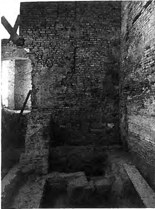
Abb. 26: Inneres, Laienkirche, ergrabene südöstliche Außenwand mit Südwand aus Bau II und ehemaligem Zugang ins östliche Seitenschiff; die Schwelle ist angeschnitten, Aufnahme H. Sahler 2008
