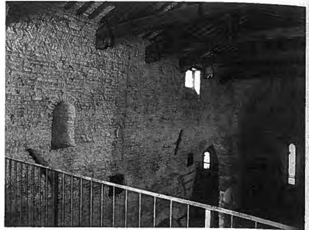
Abb. 23: Inneres, linke Obergadenwand nach Nordwesten mit Baufuge zwischen Presbyterium und Laienkirche, Aufnahme H. Sahler 2009
